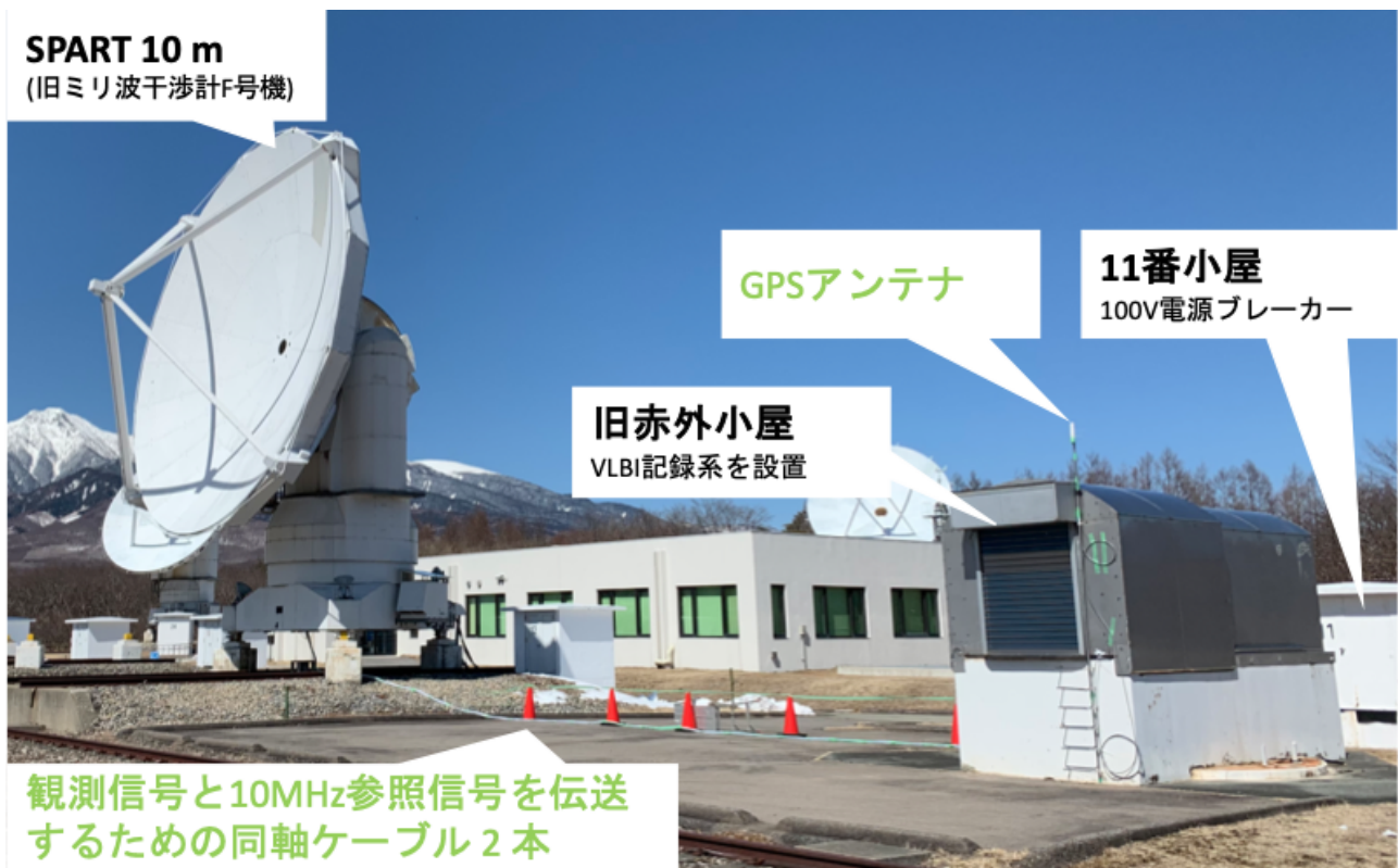
図2 システム全景とケーブル敷設経路. 30 m 同軸ケーブル 2本を SPART から旧赤外小屋に通し、観測信号と 10 MHz 参照信号を伝送する. GPS アンテナは旧赤外小屋壁面に固定した物干し竿の先端に取り付けた.
