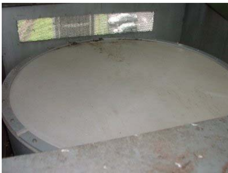
図 2 b. 上部ホーンカバー ブローアが吹き付けており、異常な汚れはない。
